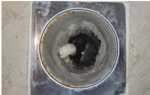
Avløp (inkl. sluk) - Sluk bad 2.etasje
