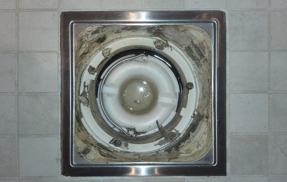
Avløp (inkl. sluk) - Sluk bad underetasje
