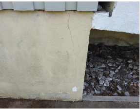
Grunnmur og fundament - Riss grunnmur
