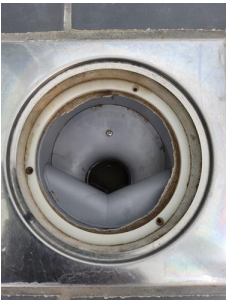
Avløp (inkl. sluk) - Sluk vaskerom dusjsonen
