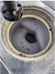
Avløp (inkl. sluk) - Sluk vaskerom under benkeskap
