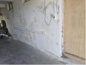
Innvendige forhold - Saltutslag og pussavskalling på veggflater.
