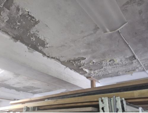
Innvendige forhold - Fukt og malingsavskalling i himling.
