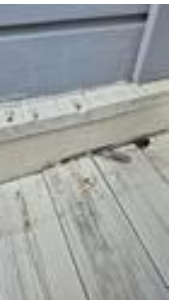
Konstruksjon og fundamenter - Råteskade bjelke
