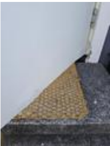
Ytterdører og omramming - Skader entrédør
