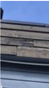
Vannbord, vindskier, gesimskasser og lignende - Slitasje/råteskader gesims 2
