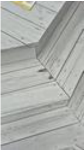
Utvendig trapp - Råteskade trapp
