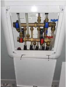
Fordelerskap og fordelerstammer - Fordelerskap og stoppekraner
