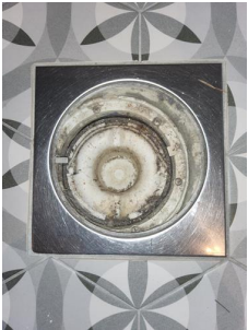
Tettesjiktets tilslutning til sluk - Sluk vaskerom
