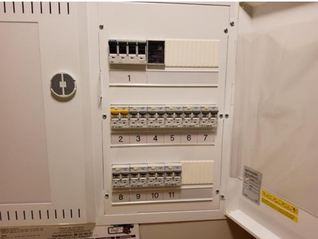
Elektrisk anlegg - [Sikringsskap ]
