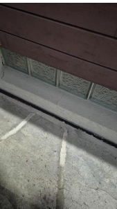
Grunnmur og fundament - Riss grunnmur
