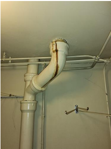
Avløp (inkl. sluk) - Rust avløpsrør
