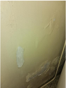
Overflater vegger - Saltutslag/pussavskalling
