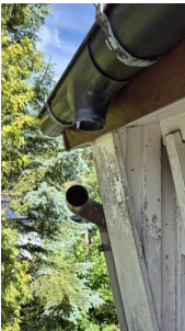
Takrenner og utvendige nedløp - Manglende nedløp
