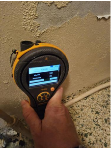
Kontroll i tilliggende konstruksjon ikke utført - Fuktsøk vaskerom
